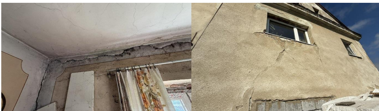
Východní stěna domu se statickým narušením - praskliny
