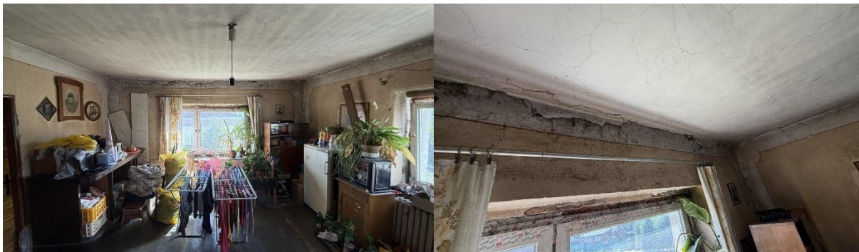
Východní stěna domu se statickým narušením - praskliny
